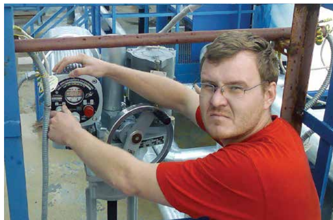
Электропривод РэмТЭК-01, Урманское нефтяное месторождение ОАО «Газпром нефть»
