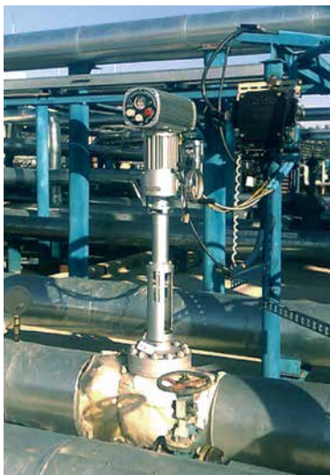
Электропривод РэмТЭК-02, Шингинское нефтяное месторождение ОАО «Газпром нефть»
