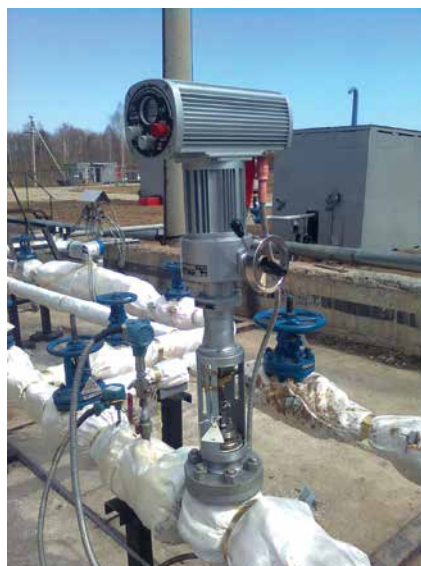
Электропривод РэмТЭК 02, пункт отпуска нефти Молчаново, ООО «Томскнефтегазпереработка»
