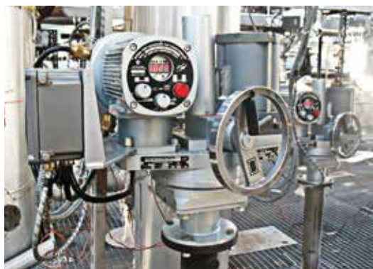
Электродвигатель «РэмТЭК» на объекте «Томского нефтехимического комбината»
