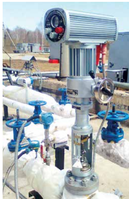
Электропривод «РэмТЭК» на объекте ОАО «НК «Роснефть»
