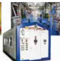
Насосная ШФЛУ газа для ГКС Северо-Остаминского НМ ОАО «Томскгазпром»
