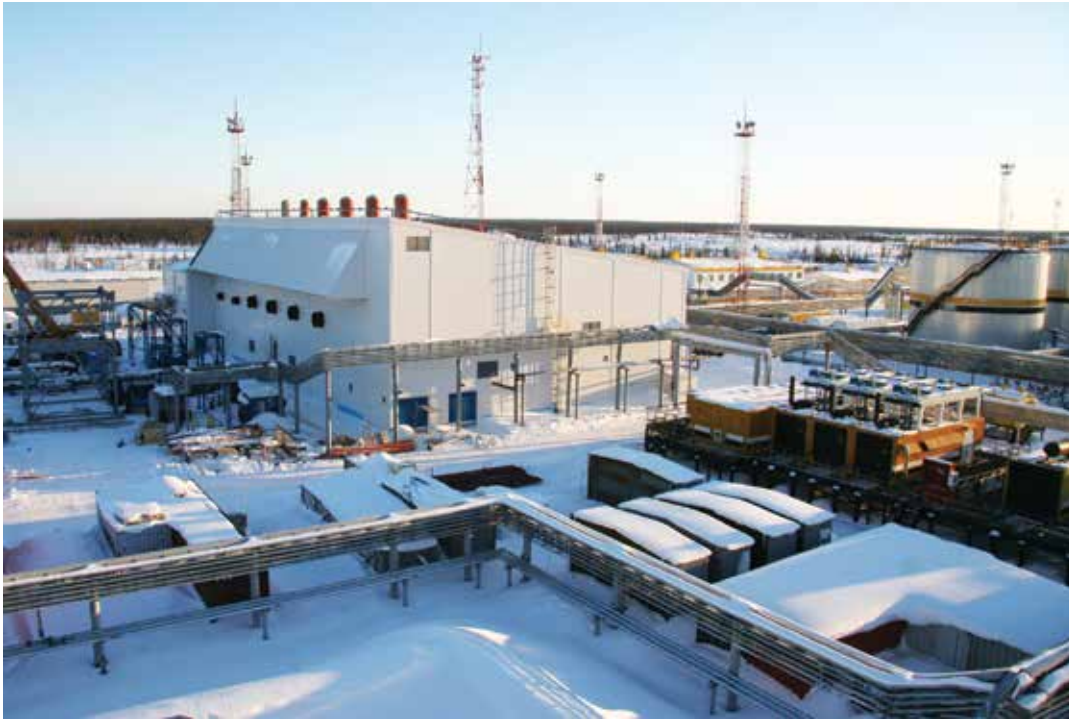
Газопоршневая электростанция 42 МВт на нефтеперекачивающей станции № 2 нефтепровода Ванкор - Пурпе для ООО «РН-КрасноярскНИ-Пинефть», выполненная по проекту НПП «ТЭК»
